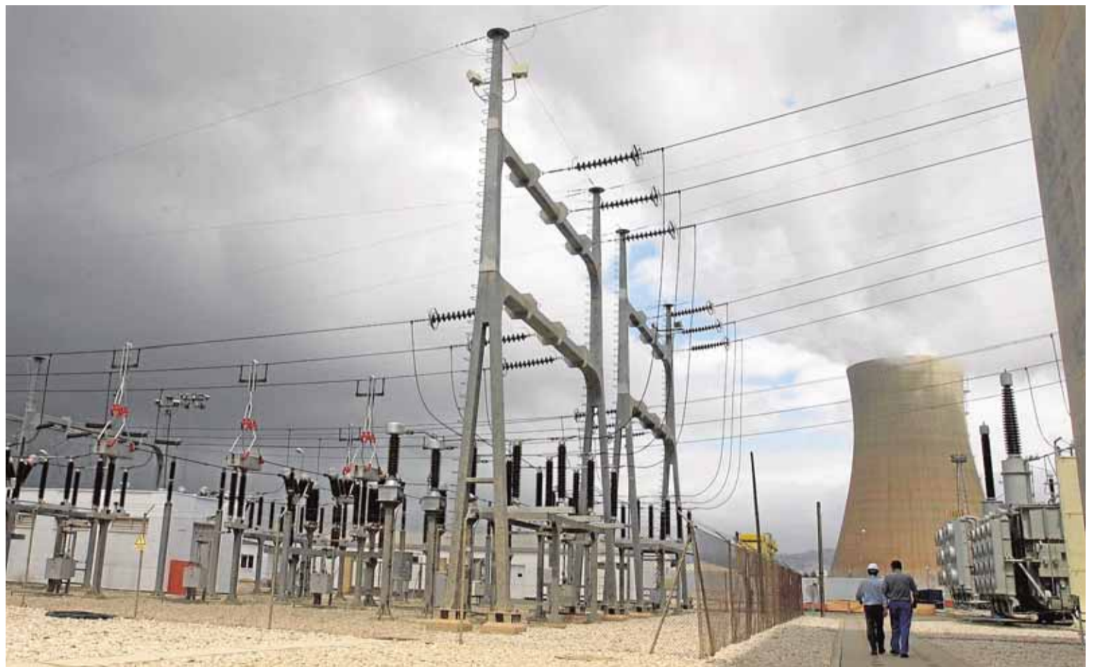
Interior de la central nuclear de Cofrentes. JESÚS SIGNES
